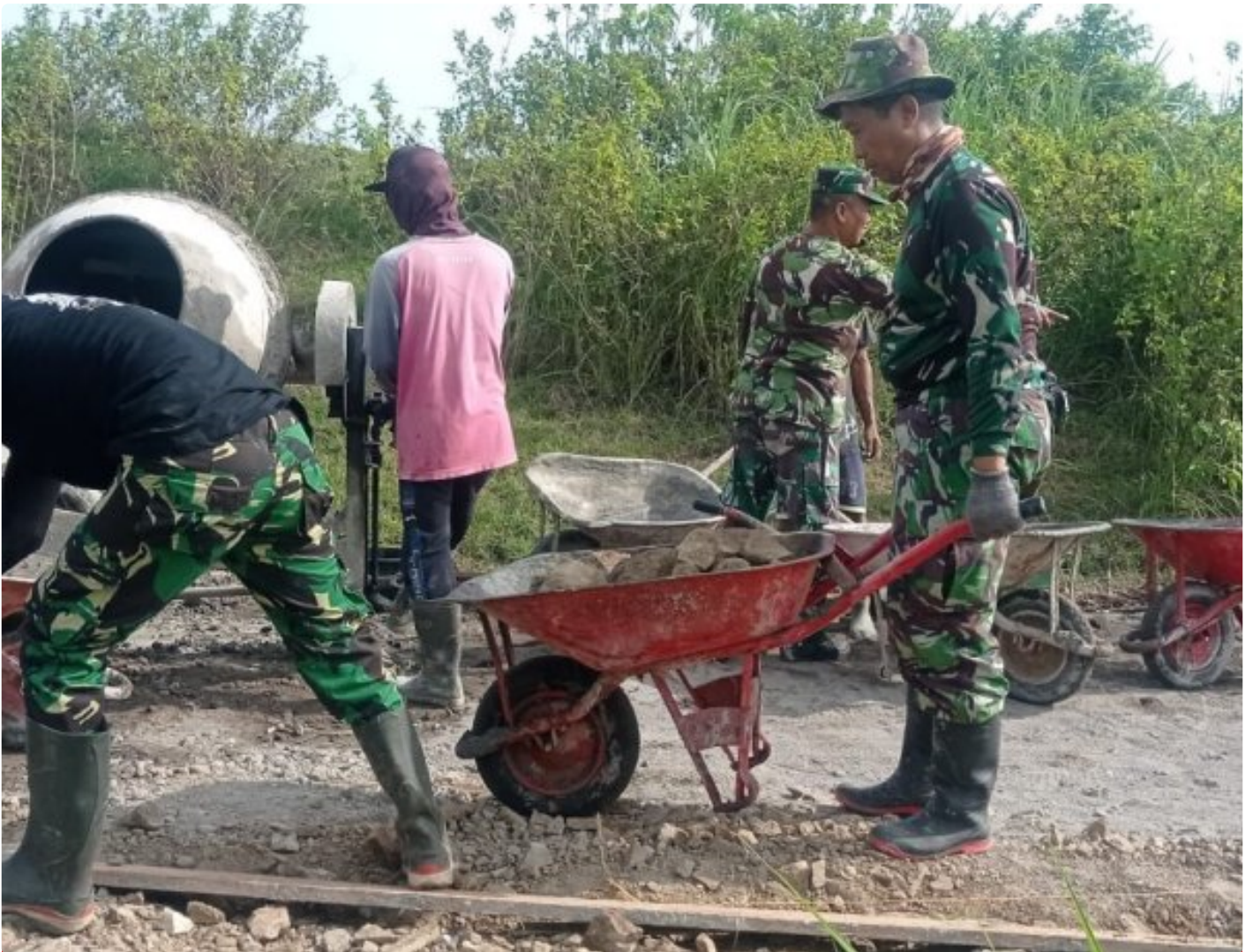
Program TMMD Sengkuyung Tahap I TA 2025 Desa Krakitan Bayat Klaten Mulai Betonisasi
