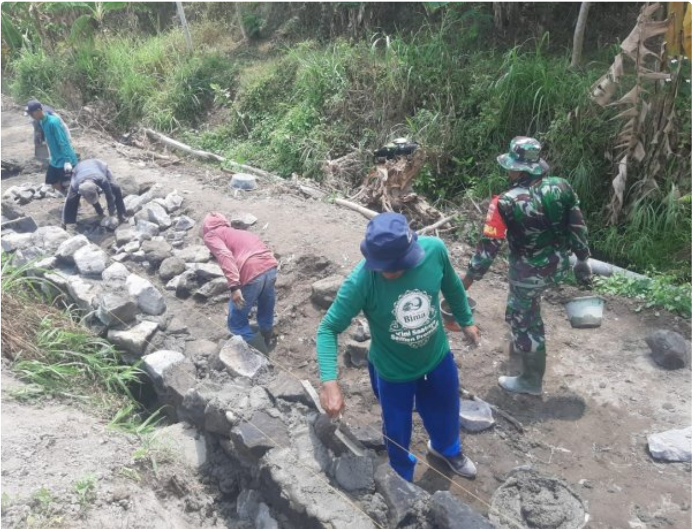
Koramil 09 Prambanan Bangun Talud Di Desa Geneng Klaten Program KBMKB, Ini Kata Danramil Prambanan
